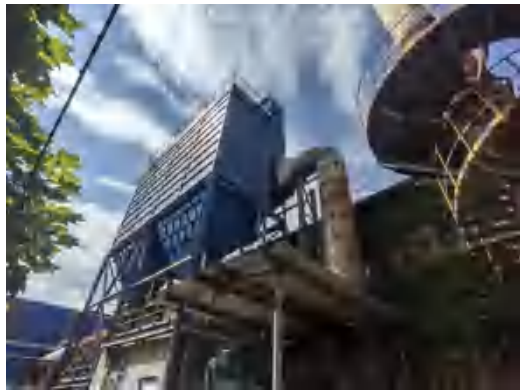
打磨工序除尘器
