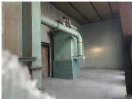
抛丸工序除尘器
