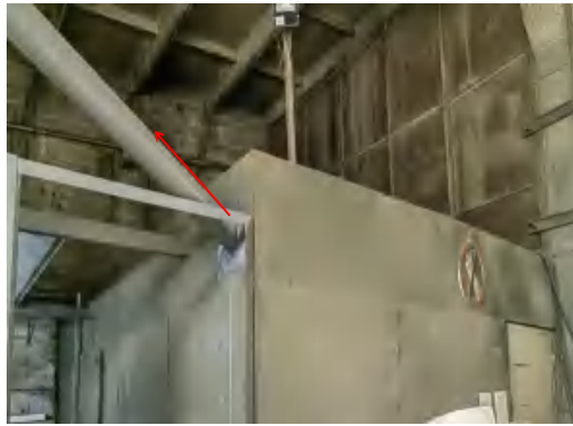
泡沫烘干废气收集管道
