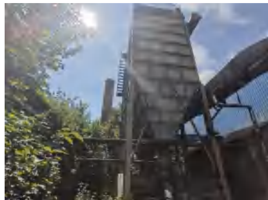
废钢切割除尘器
