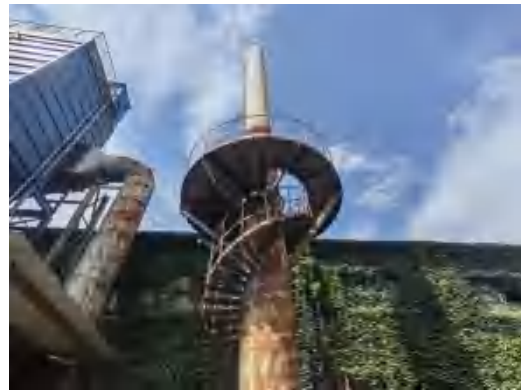
打磨工序除尘器排气筒
