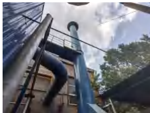
活性炭吸附/脱附+催化燃烧排气筒
