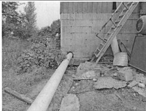
洗砂废水管道
