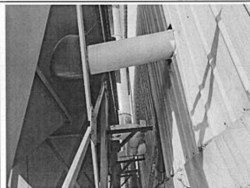
布袋除尘器进口
