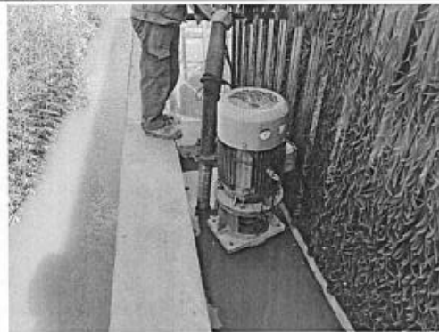
打入浓缩池泵
