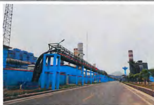
110kV 电缆桁架
