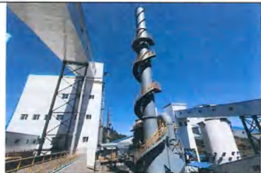
配套除尘器+排气筒
