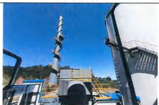
配套除尘器+排气筒
