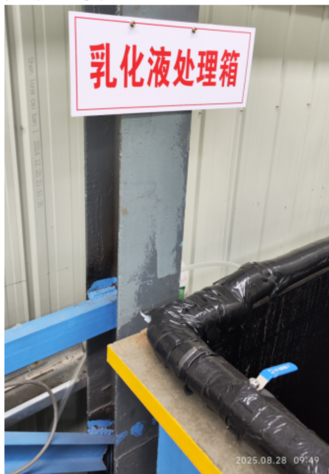
图 6 废水处理设施照片
