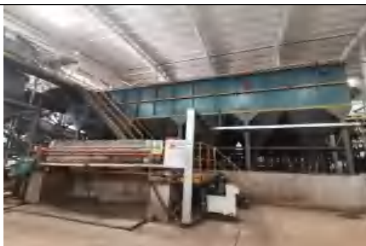
斜管沉淀+板框压滤
