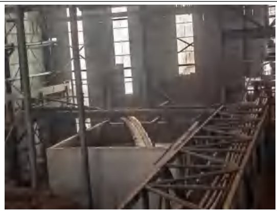
尾矿干排系统-循环水池
