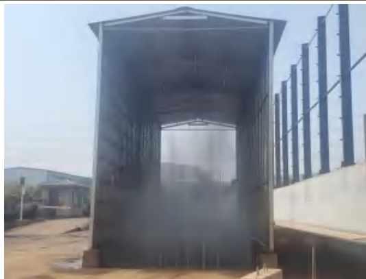
厂区出口洗车设施
