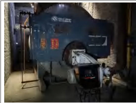
锅炉低氮燃烧
