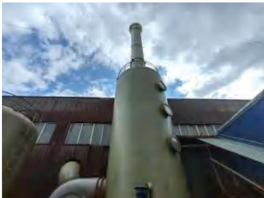
1#酸雾净化塔（碱液吸收塔）
