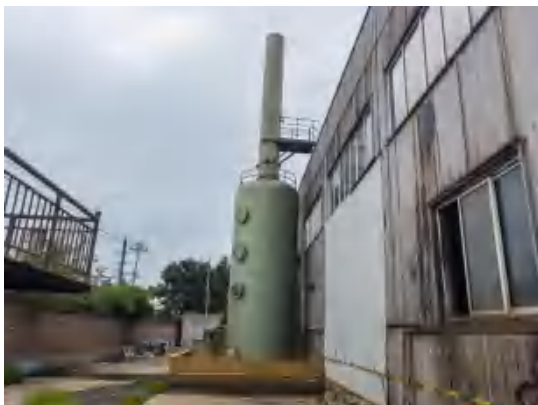
2#酸雾净化塔（碱液吸收塔）
