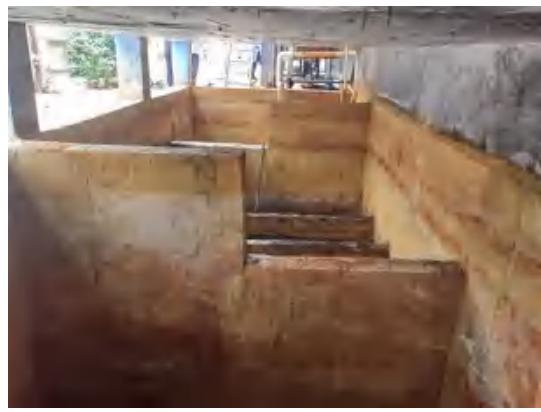
事故池（玻璃钢防渗）
