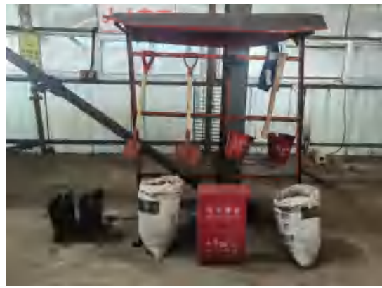
灭火器、消防沙等应急物资
