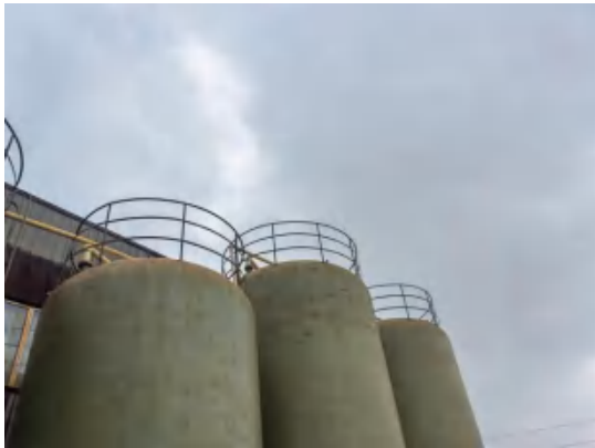
盐酸储罐废气收集管道
