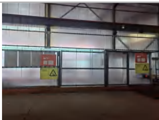
危险废物暂存间
