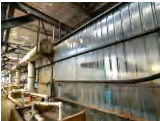
2#线封闭酸洗房+集气管道
