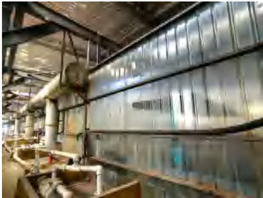
1#线封闭酸洗房+集气管道
