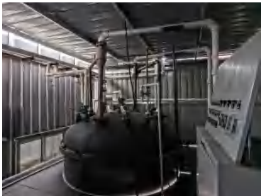
废酸处理系统废气收集管道
