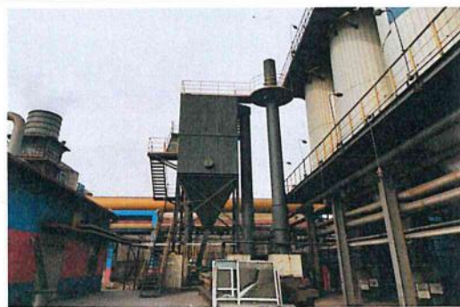
K6 转运站除尘+排气筒
