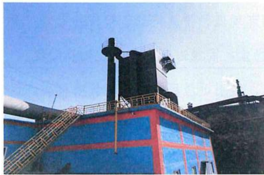
14#转运站除尘+排气筒
