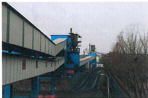
K3、K4 口转运站除尘+排气筒
