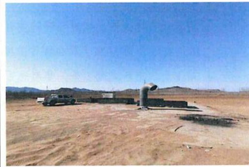
地下式转运站
