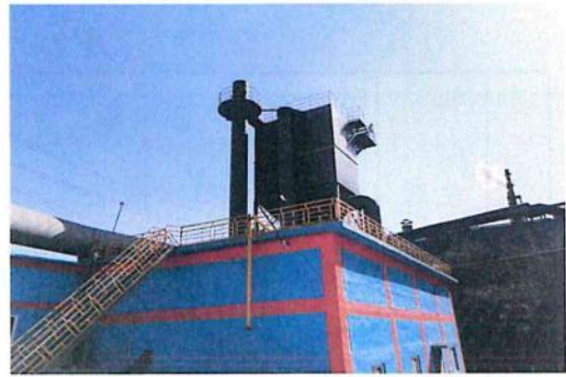
14#转运站除尘+排气筒
