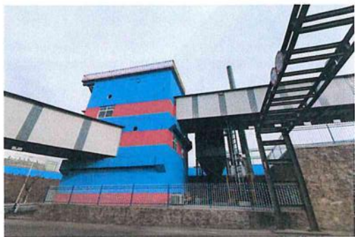
K1 转运站除尘+排气筒
