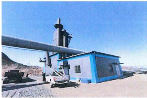
13#转运站除尘+排气筒
