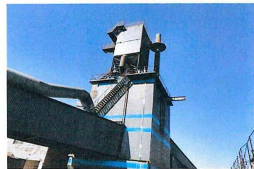
12#转运站除尘+排气筒
