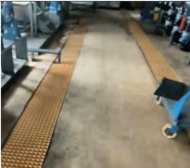
污水站收集沟
