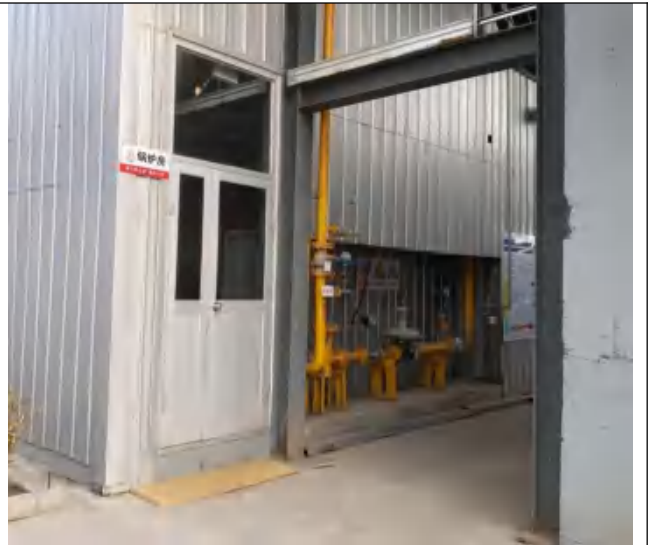
锅炉房燃气报警器
