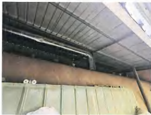
除尘灰罐装废气收集管道
