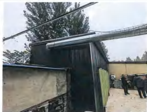
除尘灰罐装废气收集管道
