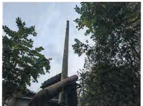
2#布袋除尘器排气筒
