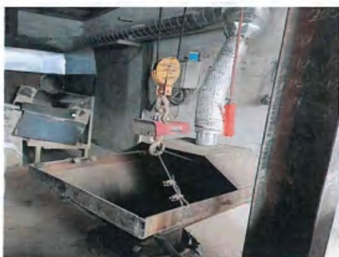
配料废气收尘管道
