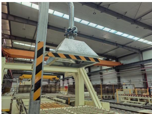
管边涂覆及烘干工序集气罩 中空玻璃生产线
