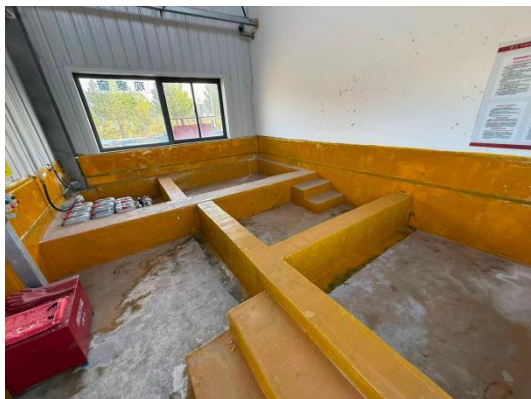
危废间内分区
