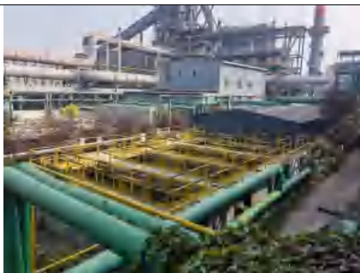
综合污水处理站
