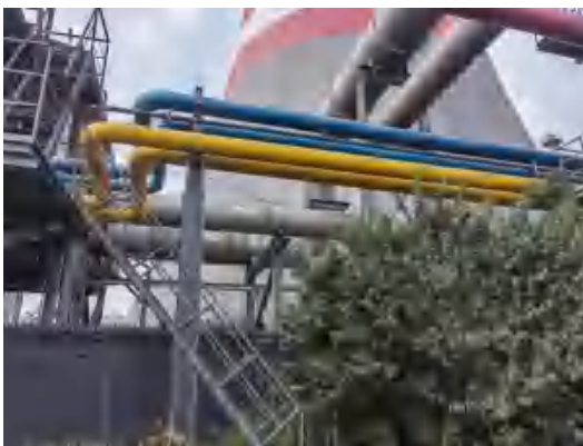
煤气管道设有识别色和流向
