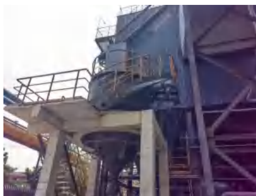
脱硫灰仓仓顶除尘
