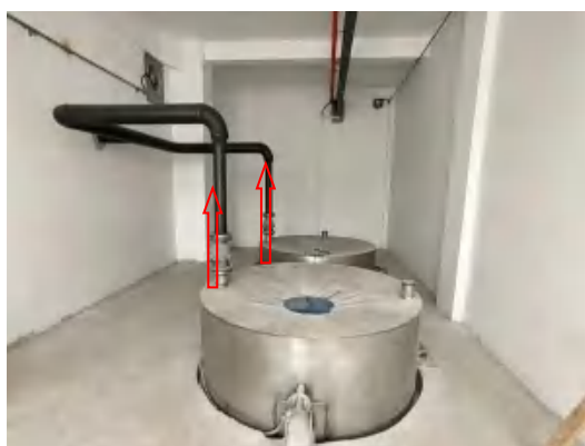
脱硫剂仓收尘管道
